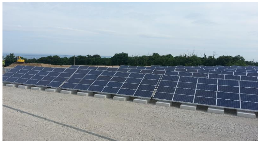
石川縣2MW地面型電廠
